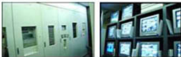
CCTV保安\消防警备装置
